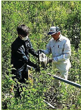
作業は3班に分かれ行った、写真は真滝バイパスでの状況
